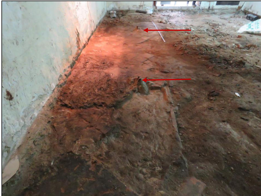
Al fons el paviment UE 110 amb les restes de pilars de ferro UE 112 (fletxes en vermell) i en primer terme l'envà UE 113
