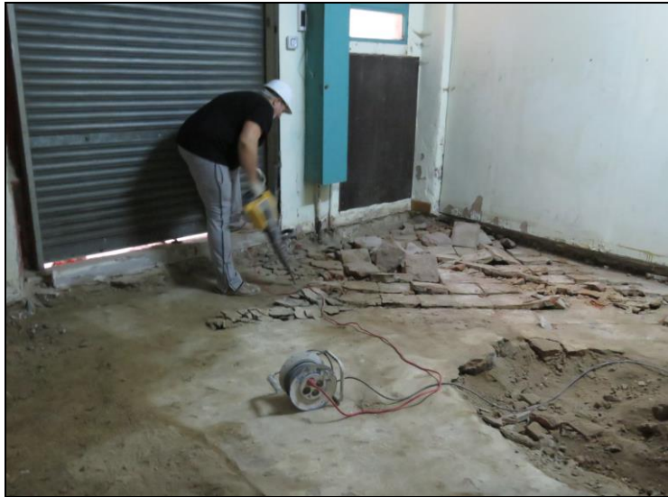
Afectació mecànica del paviment UE 104
